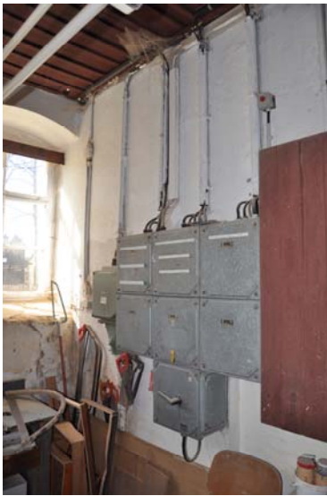
Motorraum mit Hauptanschluss
